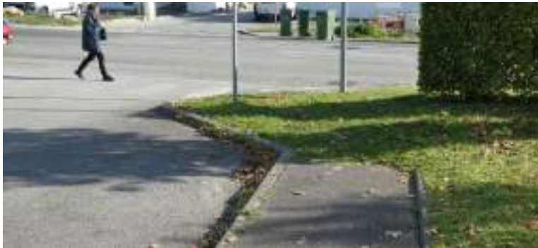
Discontinuité de cheminement entre la rue Picasso et la rue Cadoudal.
